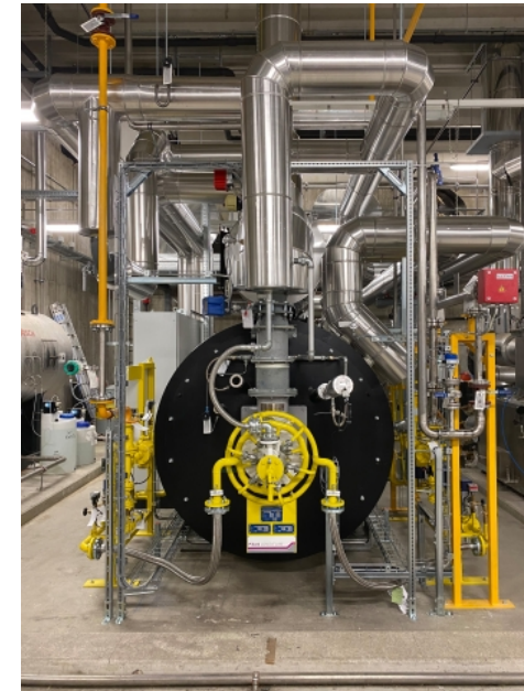
📷 Der neue Zweistoffbrenner der Bäckerei Therese Molk ist wichtiger Bestandteil des ...weiter
